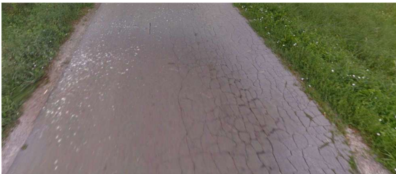
Slika 4: Občinska asfaltna cesta z oznako JP 633151 z razpokami in manjšimi posedki
